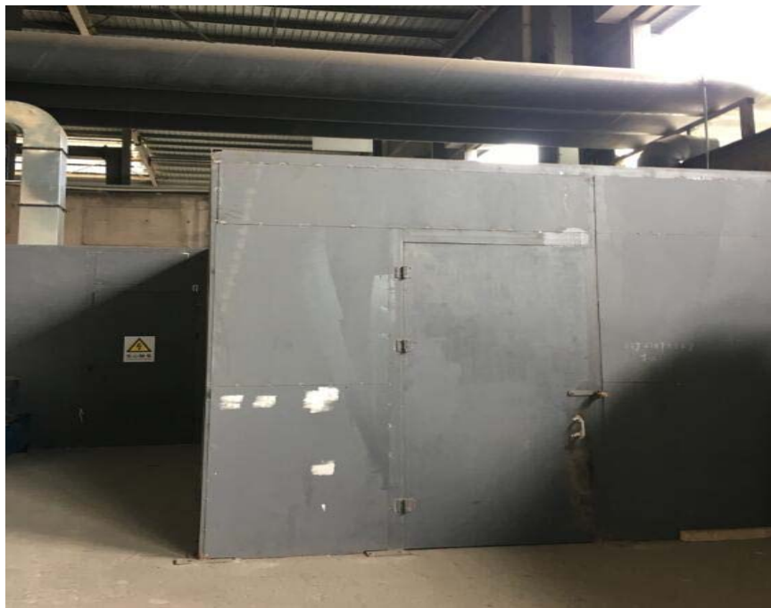
车间内 空压间密闭隔声
