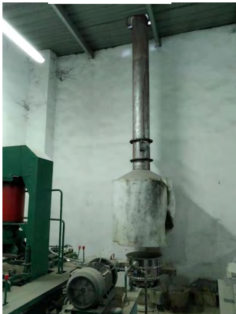
投料粉尘收集口
