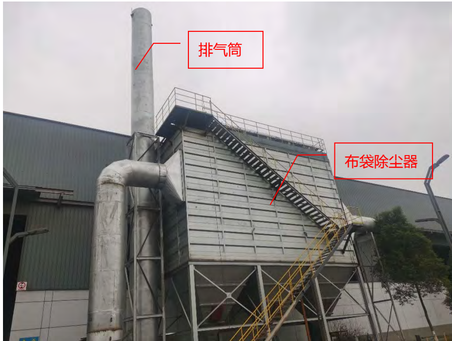
3.1-4 二阶段废气处理设施及排放口现场图
