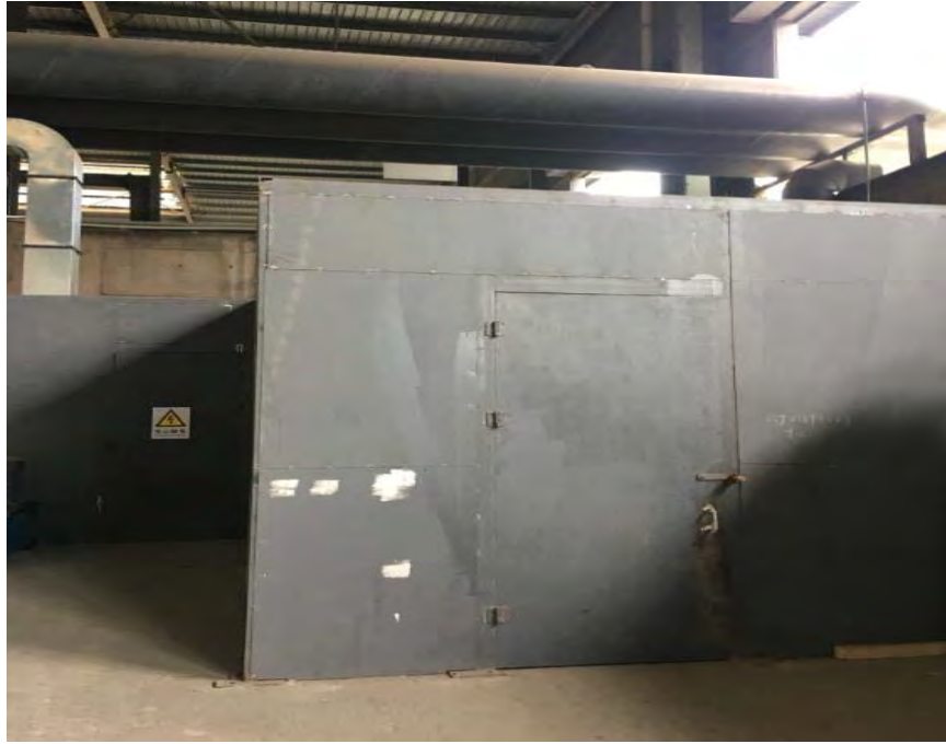
车间内 空压间密闭隔声
