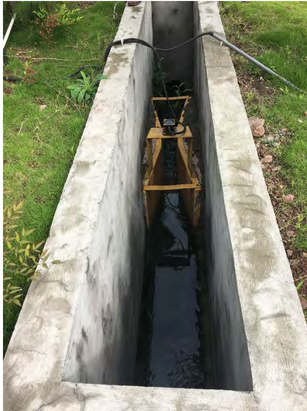
图 3.1-2 依托重庆新格生活污水处理设施现场情况图（排水计量堰）
