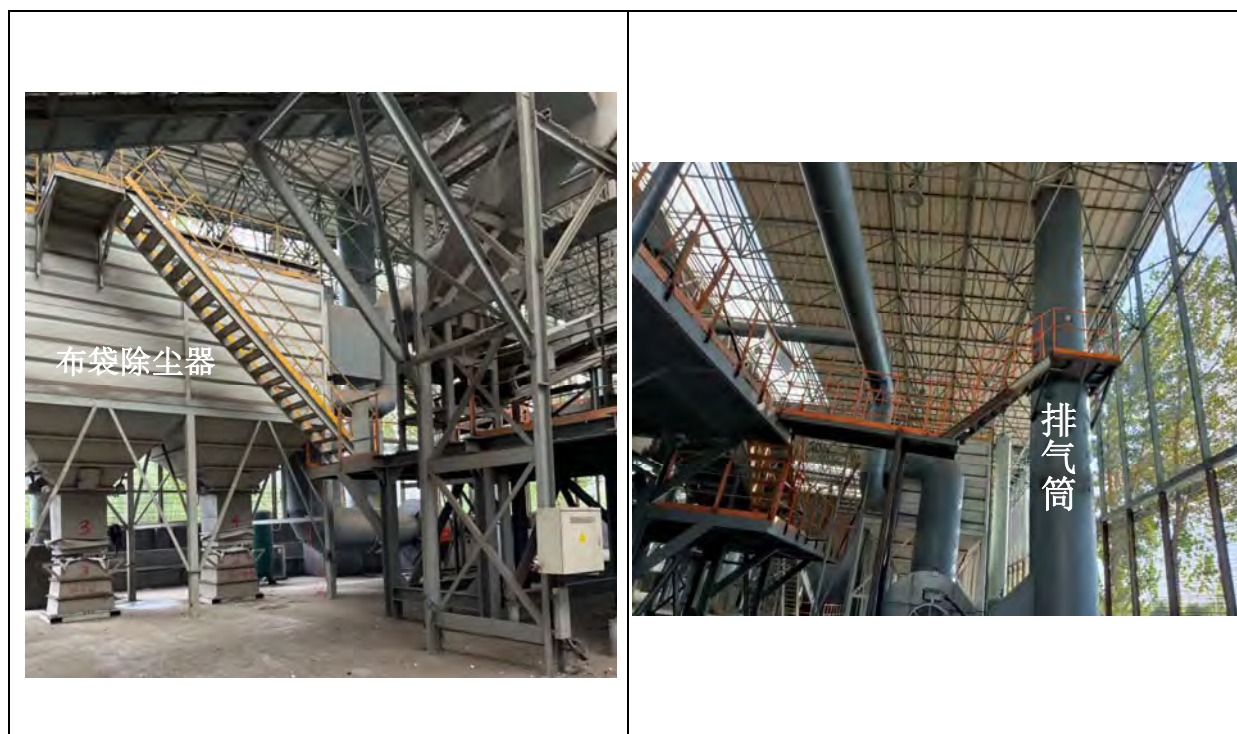
资材二车间布袋除尘器+18m 高排气筒 P4
