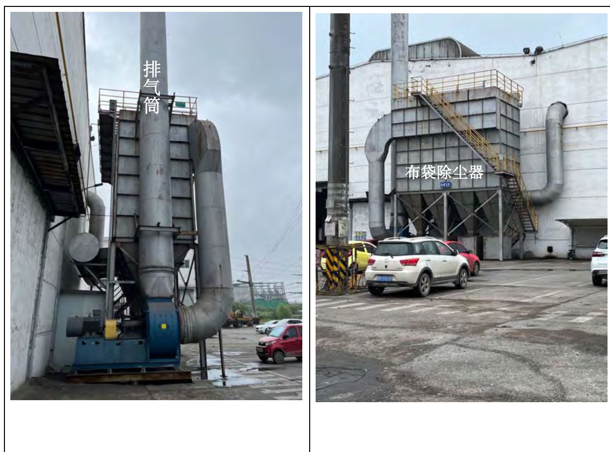
资材一车间布袋除尘器+18m 排气筒 P1
