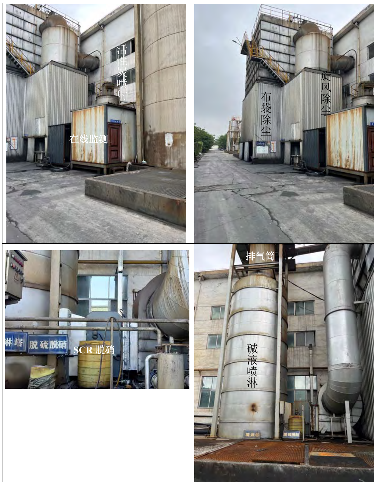
熔炼废气处理系统：“骤冷+活性炭喷射+旋风除尘+布袋除尘系统+SCR 脱硝+碱液喷淋” +25m 高排气筒 P2
