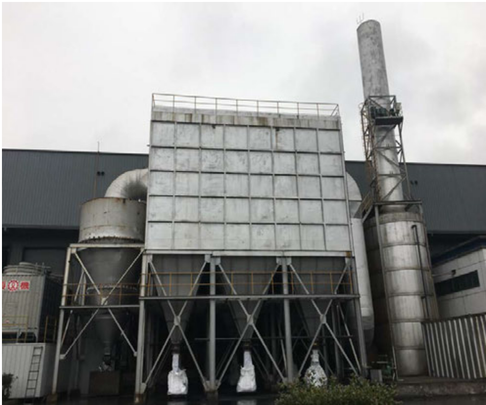
3#线旋风除尘+布袋除尘+水喷淋+排气筒 (DA010)
