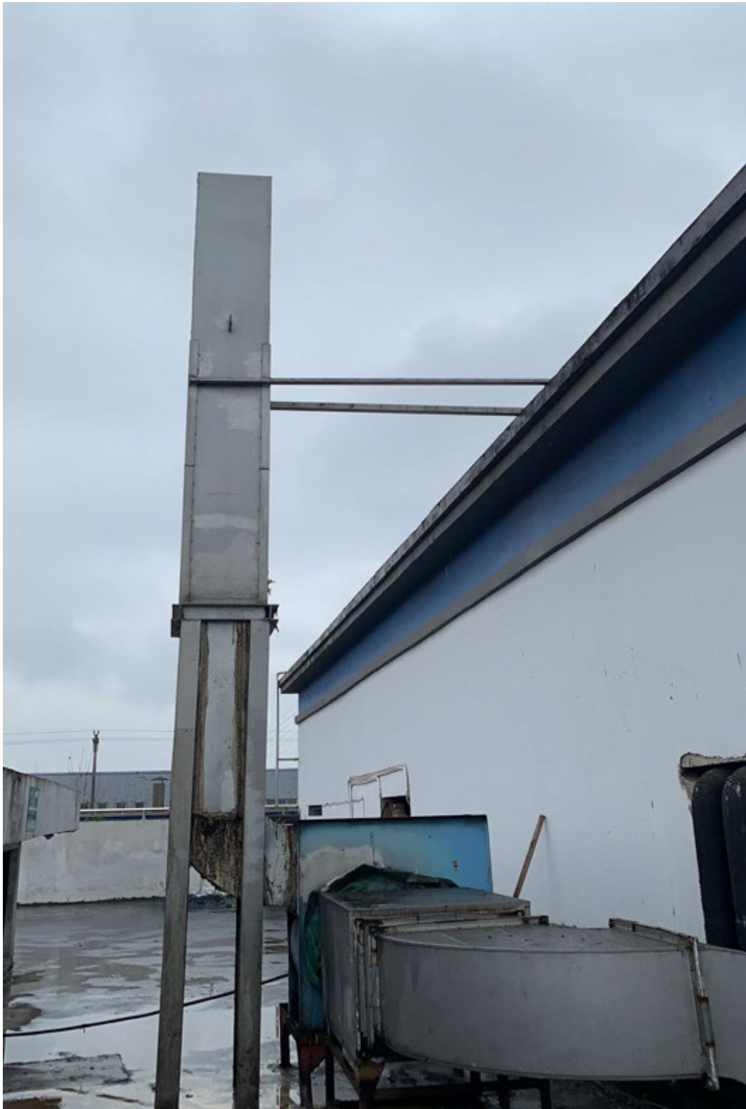
食堂油烟净化器及排气筒
