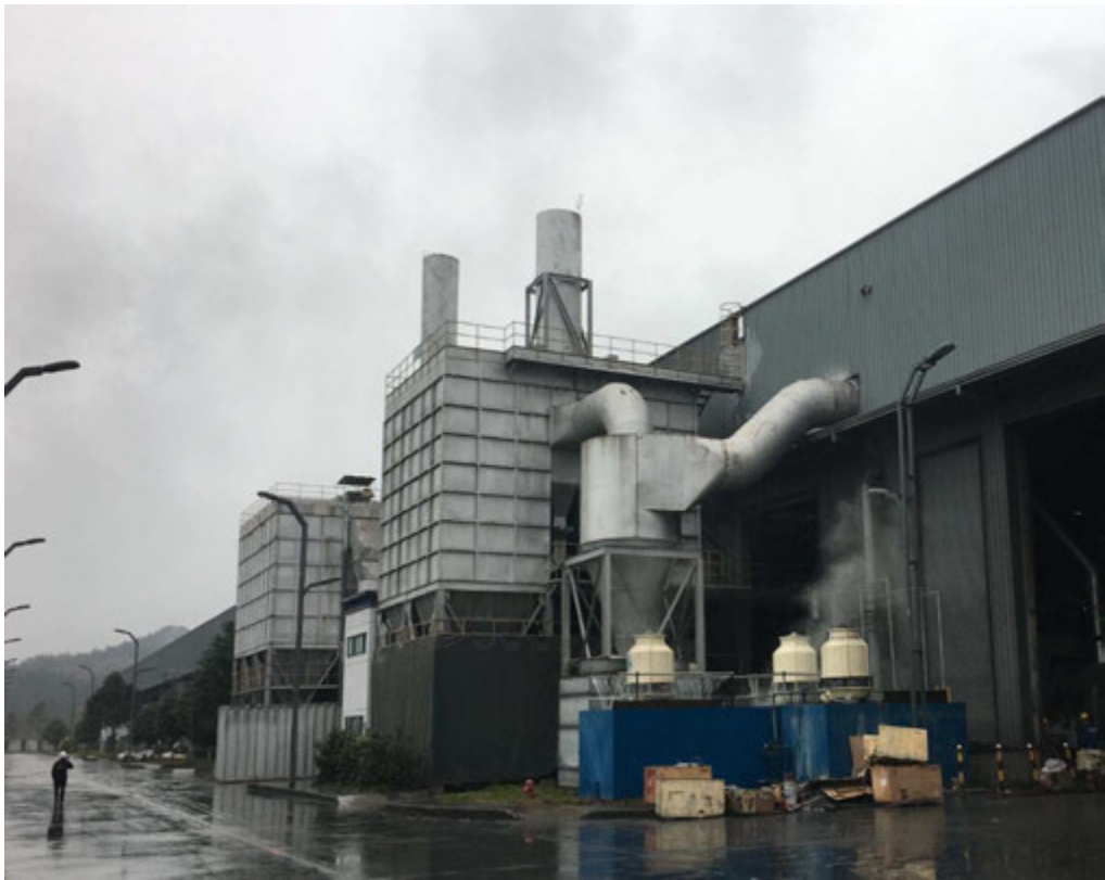
铝灰处理和回转炉旋风除尘+布袋除尘+排气筒（DA003）
