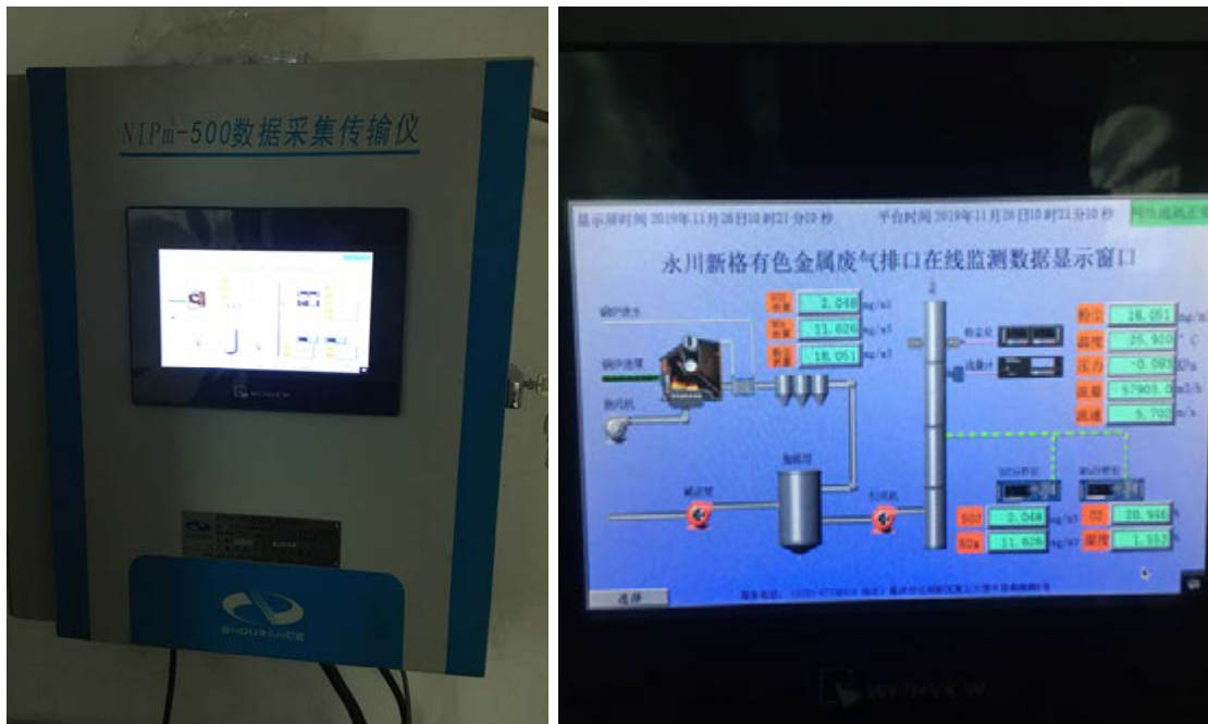
3#线排气筒 (DA010) 废气在线监测系统
