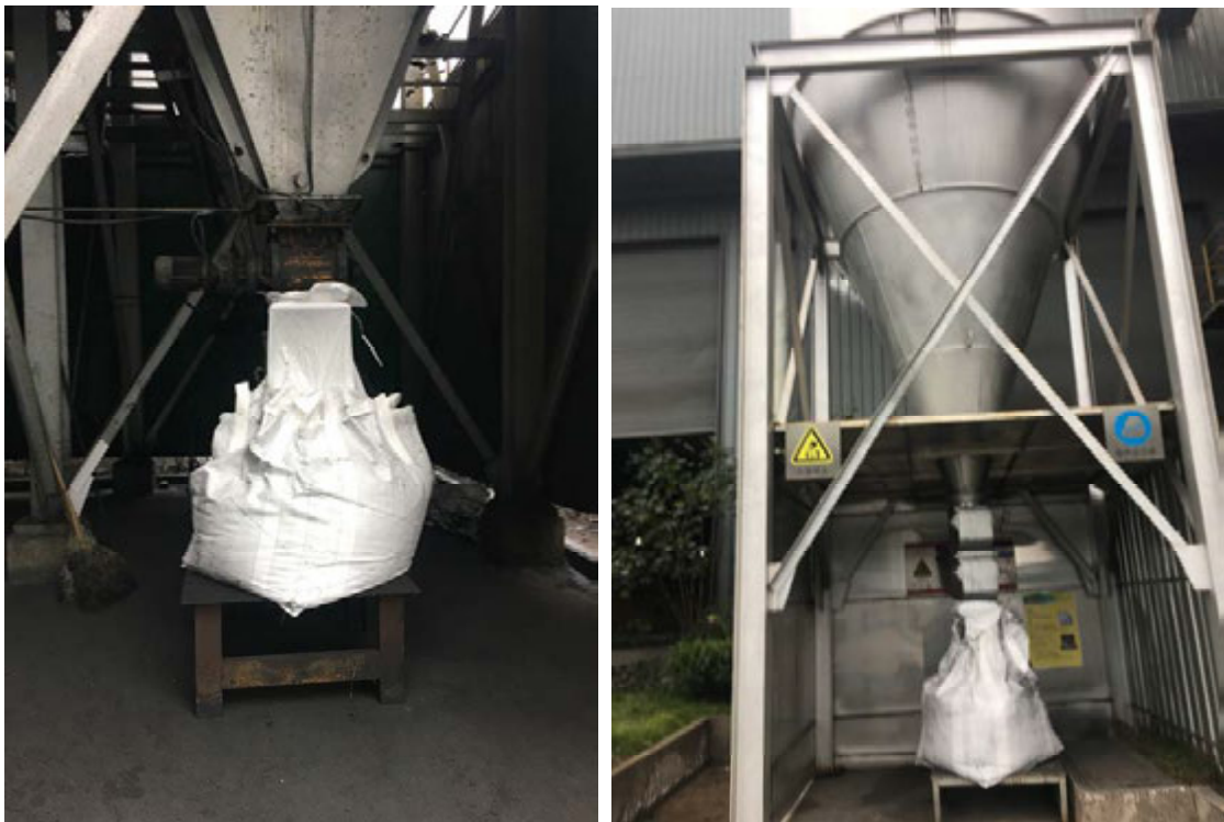
各除尘器除尘灰密闭收集措施（部分示意）
