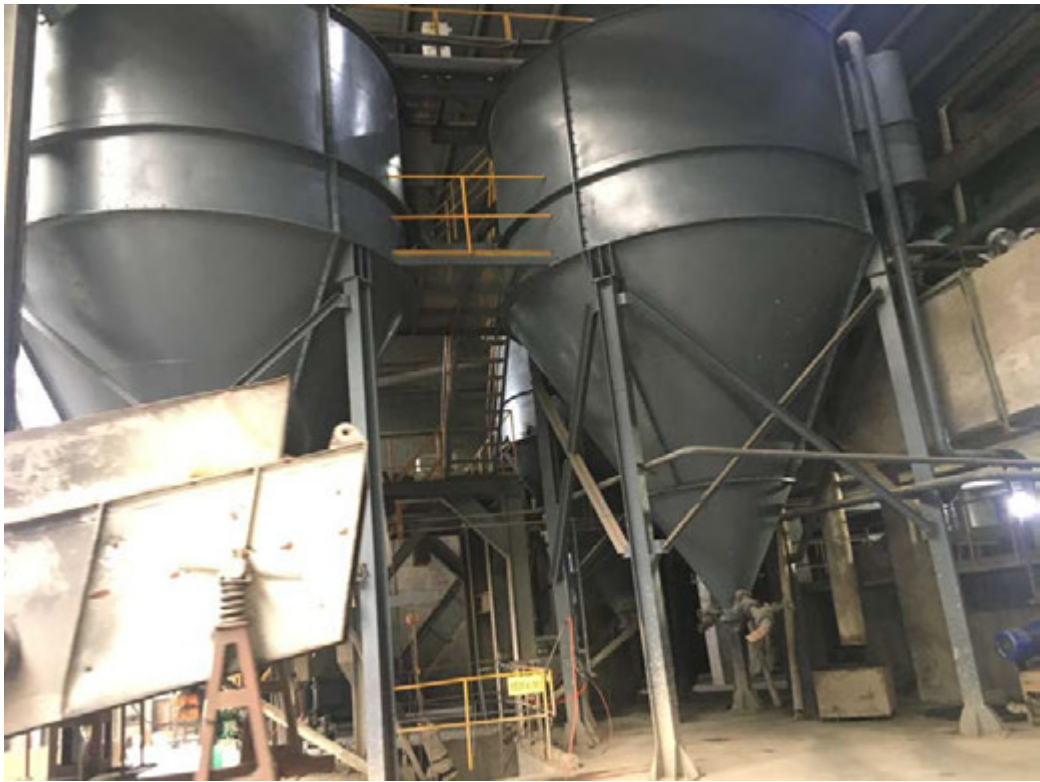
浮选废水沉淀池（地上）
