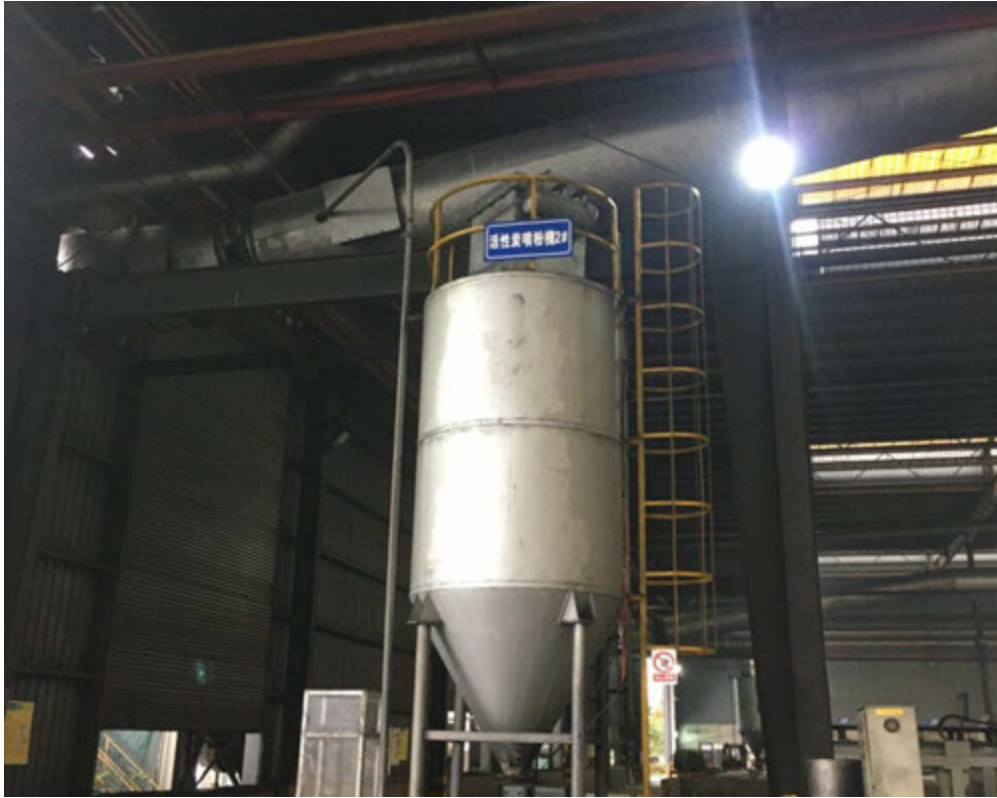
2#线收集管网+活性炭喷射
