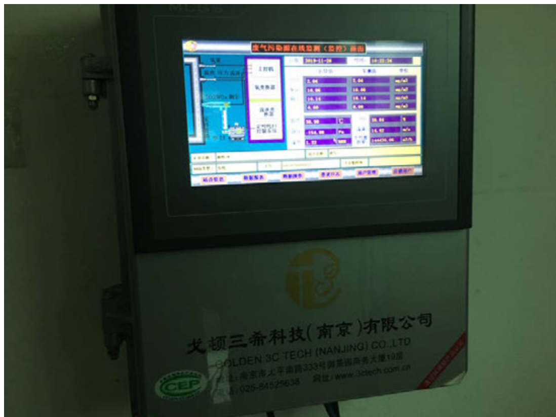
铝灰处理和回转炉废气排气筒 (DA003) 在线监测系统
