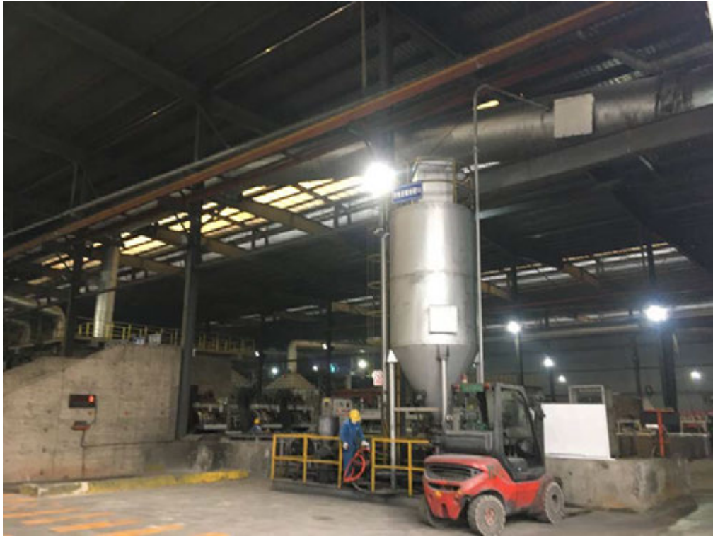
1#和 4#线收集管网+活性炭喷射
