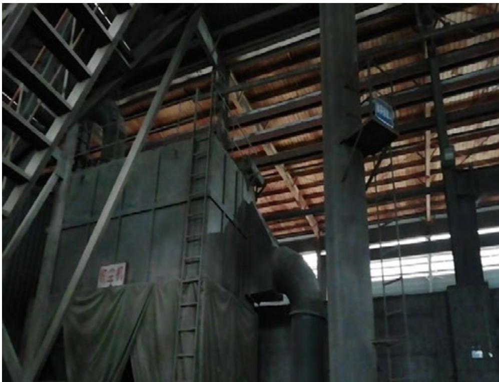
破碎机布袋除尘+排气筒 (DA004)
