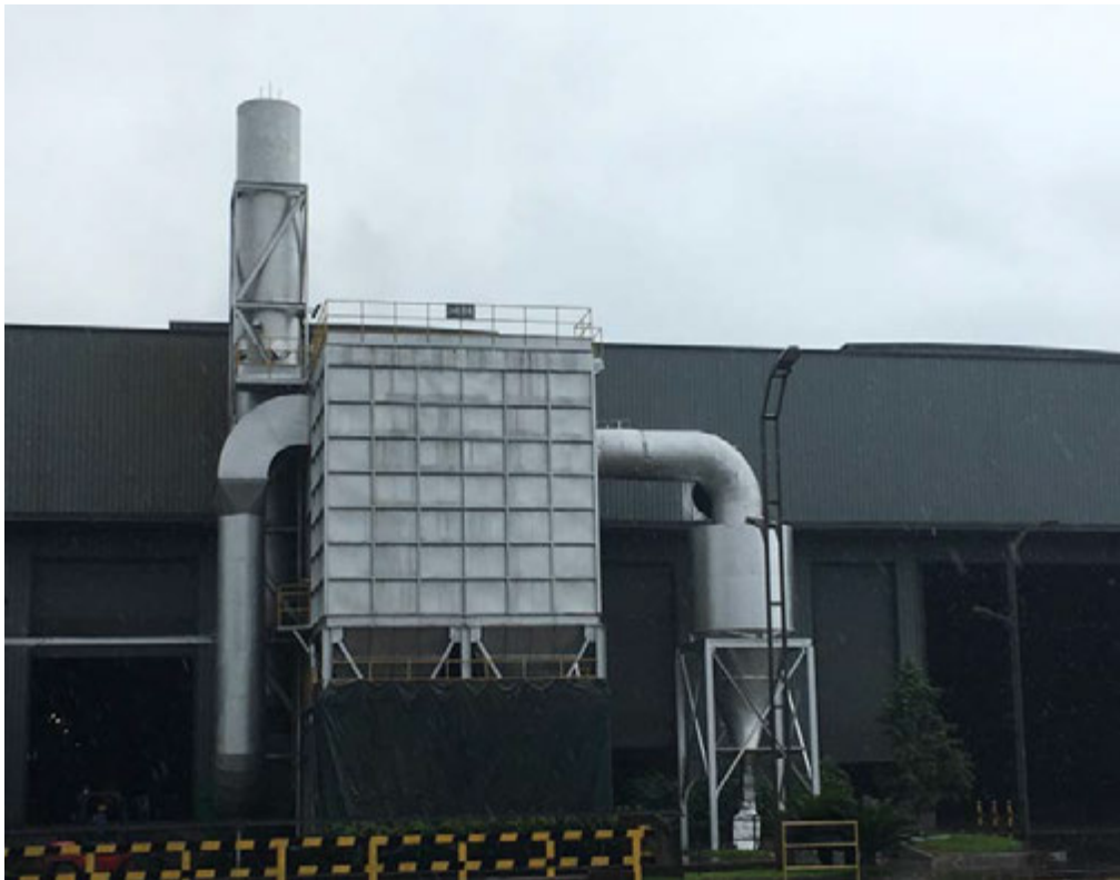
2#线旋风除尘+布袋除尘+排气筒（DA002）
