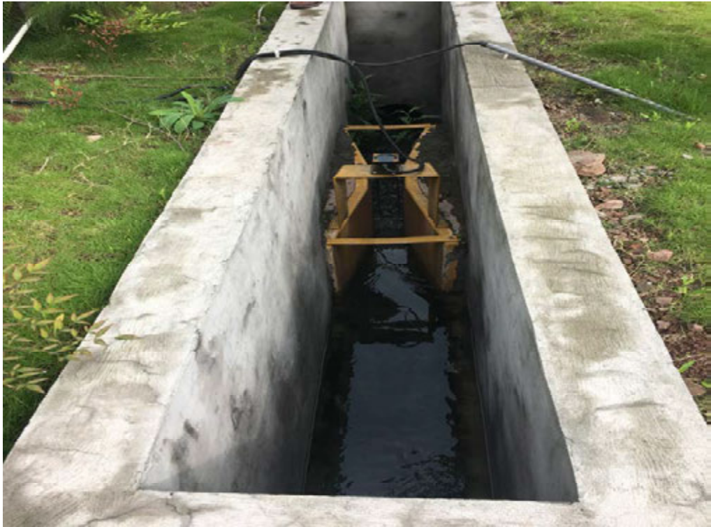
生活污水排放口（处理设施位置地下）
