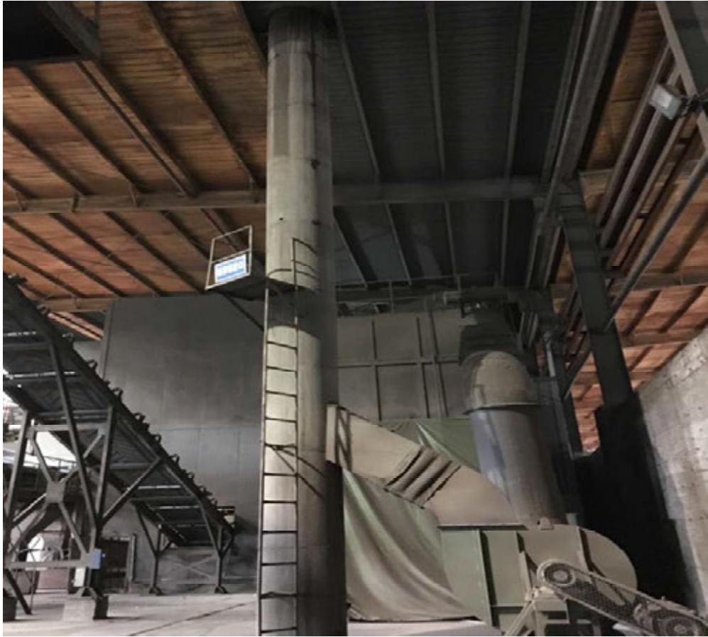
破碎机布袋除尘+排气筒 (DA004)
