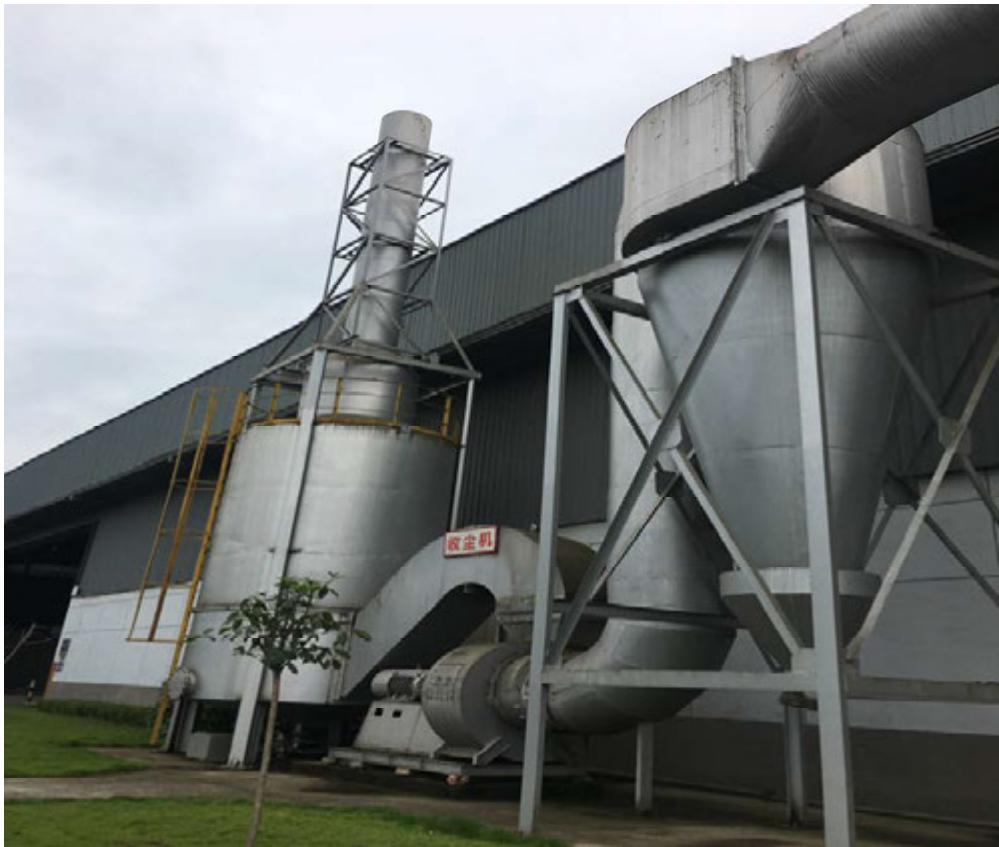
破碎机旋风除尘+水喷淋+排气筒 (DA005)
