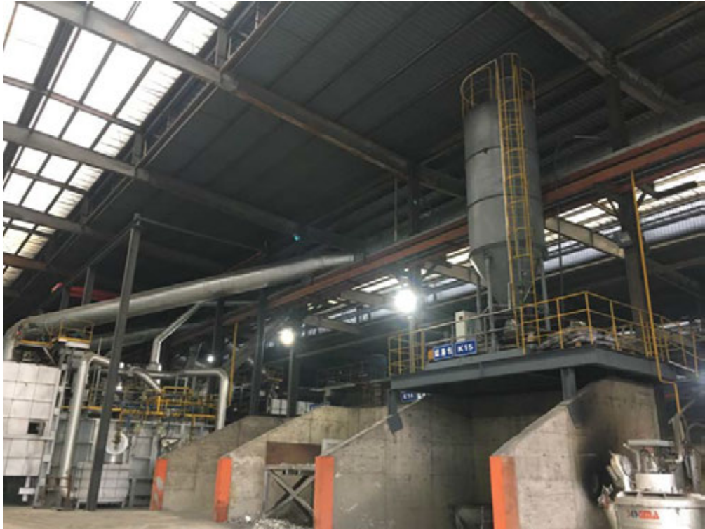
3#线收集管网+活性炭喷射
