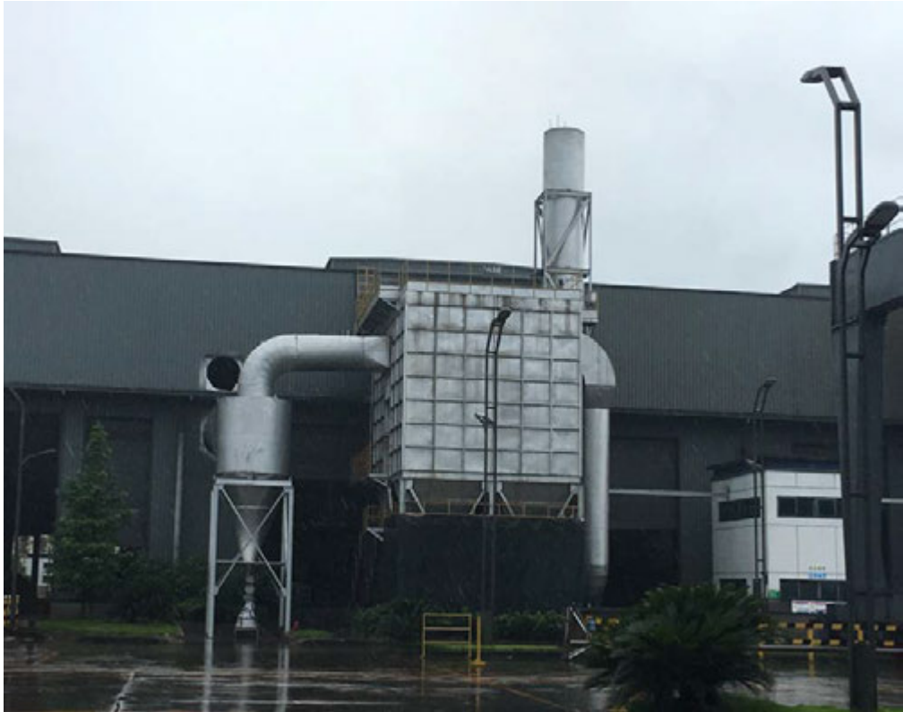
1#和 4#线旋风除尘+布袋除尘+排气筒 (DA001)
