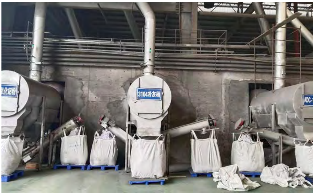
图 3.1-4 车间内废气收集管网现场图（冷却机及包装）
