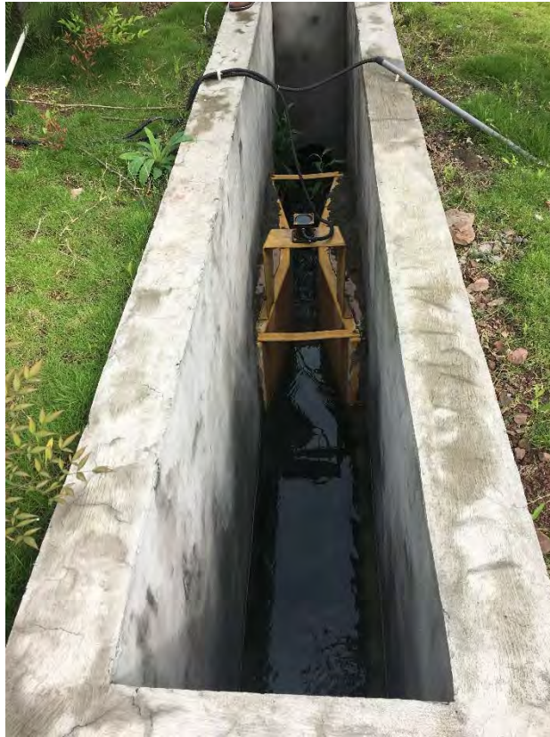
图 3.1-2 重庆新格生活污水处理设施现场情况图（排水计量堰）
