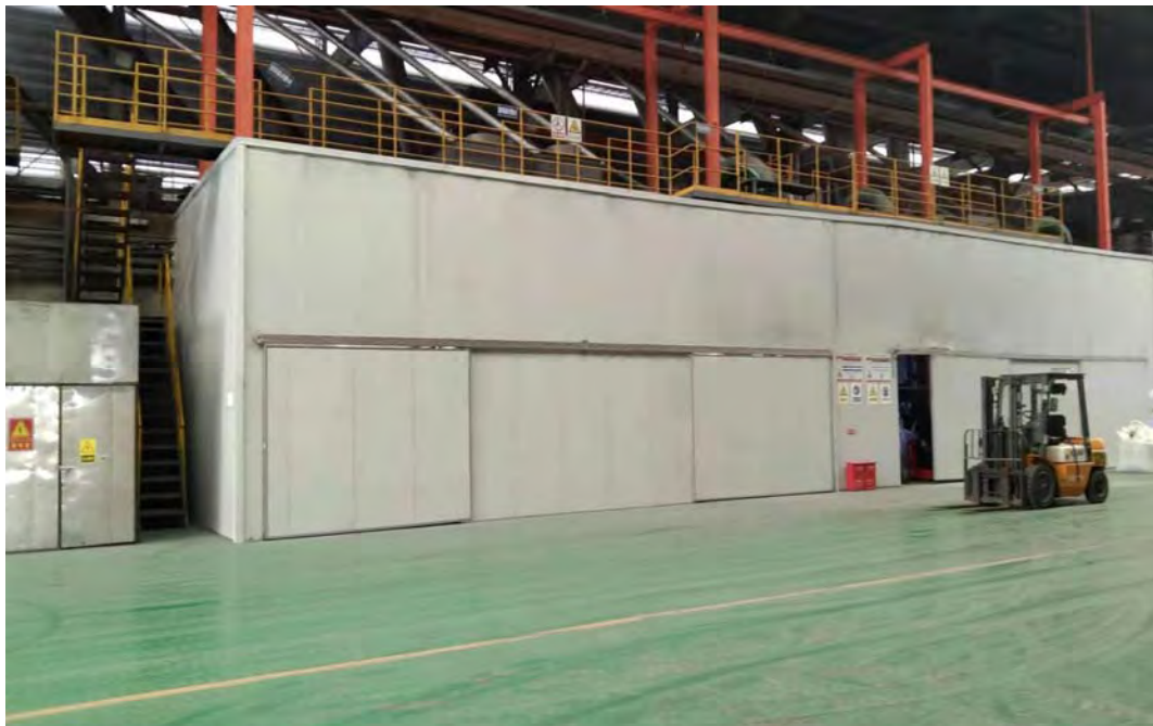
图 3.1-4 车间内废气收集管网现场图（筛分破碎）
