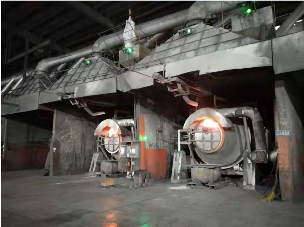
图 3.1-4 车间内废气收集管网现场图（回转炉收集管网）
