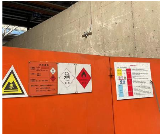
图 2 铝灰、除尘灰危废暂存间氨气检测器
