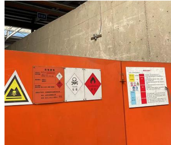
图 3-9 铝灰、除尘灰危废暂存间氨气检测器
