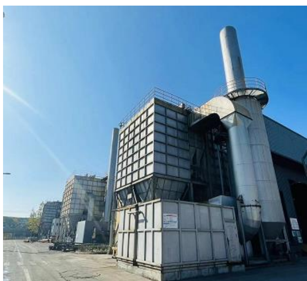
图 3-7 脉冲布袋除尘器及排气筒照片
